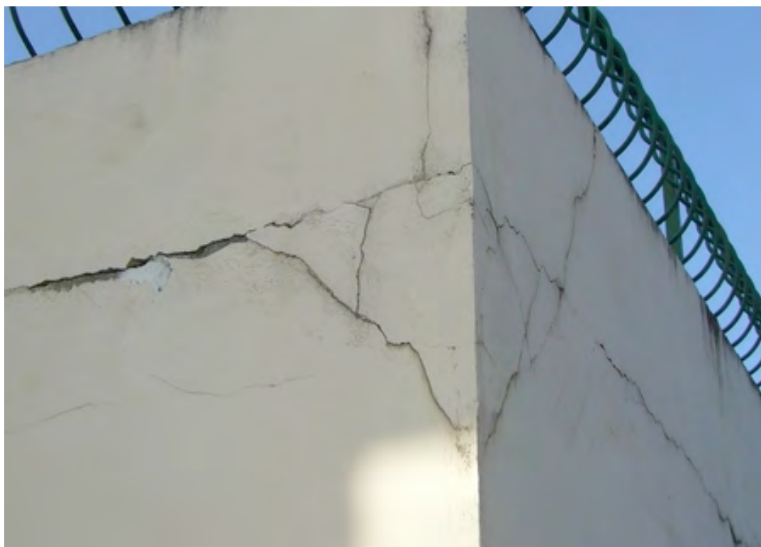
Fissures liées au phénomène de pont thermique au niveau de l'acrotère.
